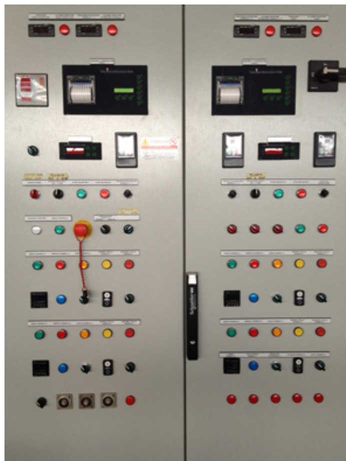
Quadro elettrico doppia linea Double line control board
