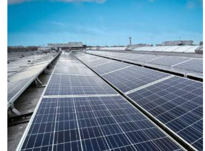
Photovoltaic system on the company building in Flintbek Photovoltaik Anlage auf dem Firmengebäude in Flintbek
